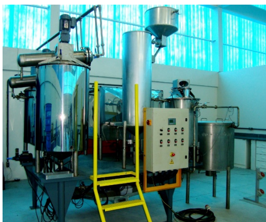
Fig. 1. Registro fotográfico da planta de biodiesel.
