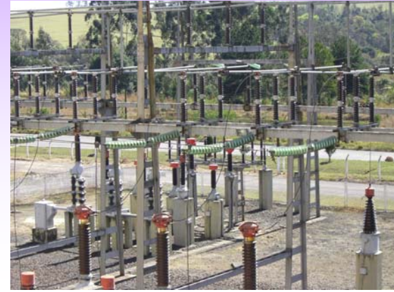
PRODUÇÃO DE ENERGIA ELÉTRICA
