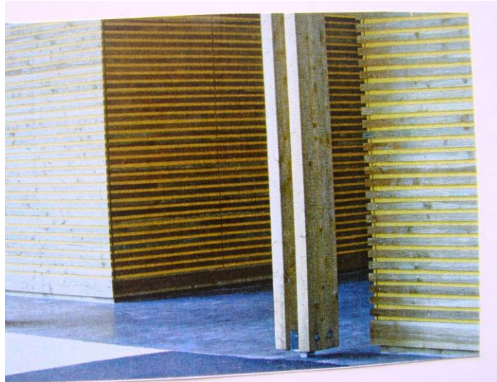
Figura 4- Afastamento do pilar de madeira do solo
