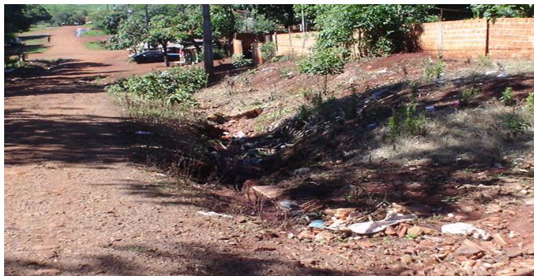
Fig. 3 - erosão das ruas devido às águas pluviais.
