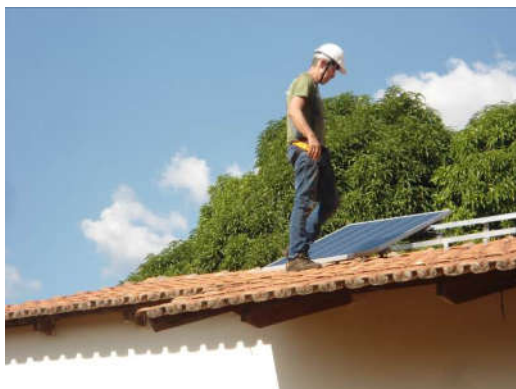
Fig. 7. Implantação do sistema fotovoltaico na Casa Legal no Jardim Curitiba, Goiânia – Goiás, fonte: AGEHAB (2016)
