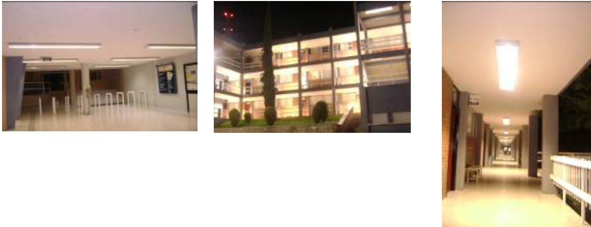
Figura 7. Luminarias en pasillos del edificio Turismo/ ECEA
