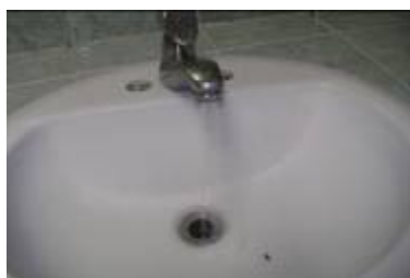
Figura 4. Llaves de baños
