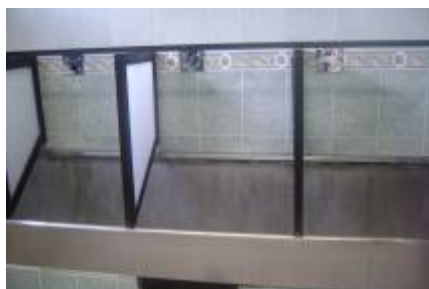
Figura 1. Mingitorios que actualmente funcionan en el edificio Turismo/ECEA
