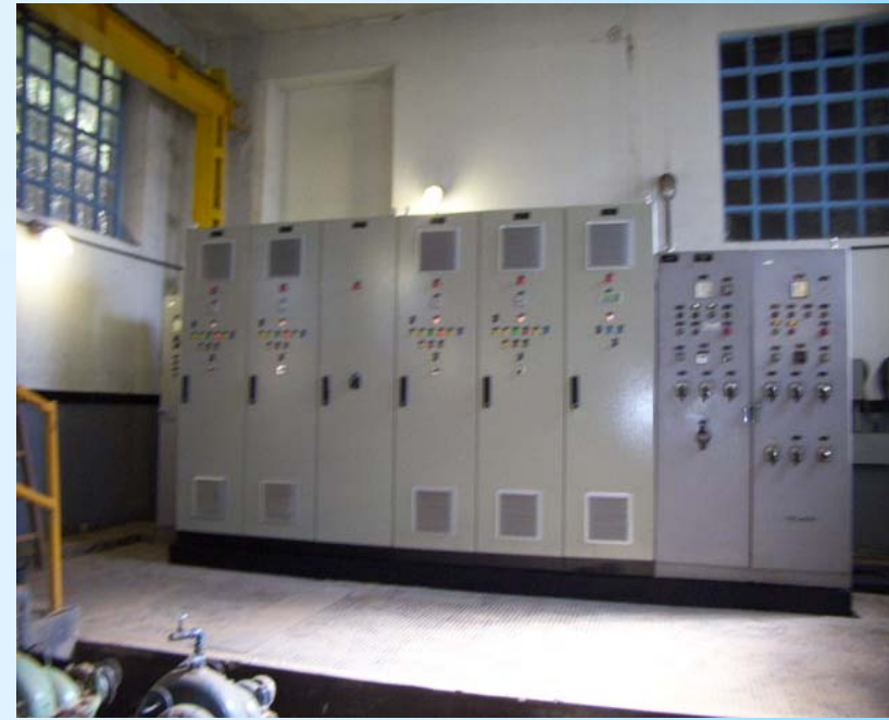
Painéis de Acionamento dos Motores
