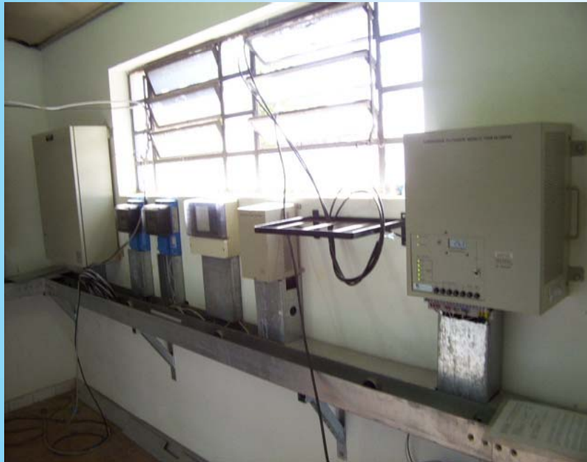
Painéis de Automação
